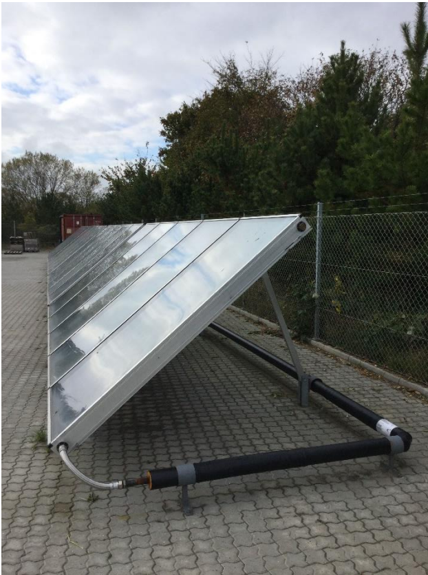
Figur 3.2: De 4 GoT paneler i Løgstørs testopstilling
