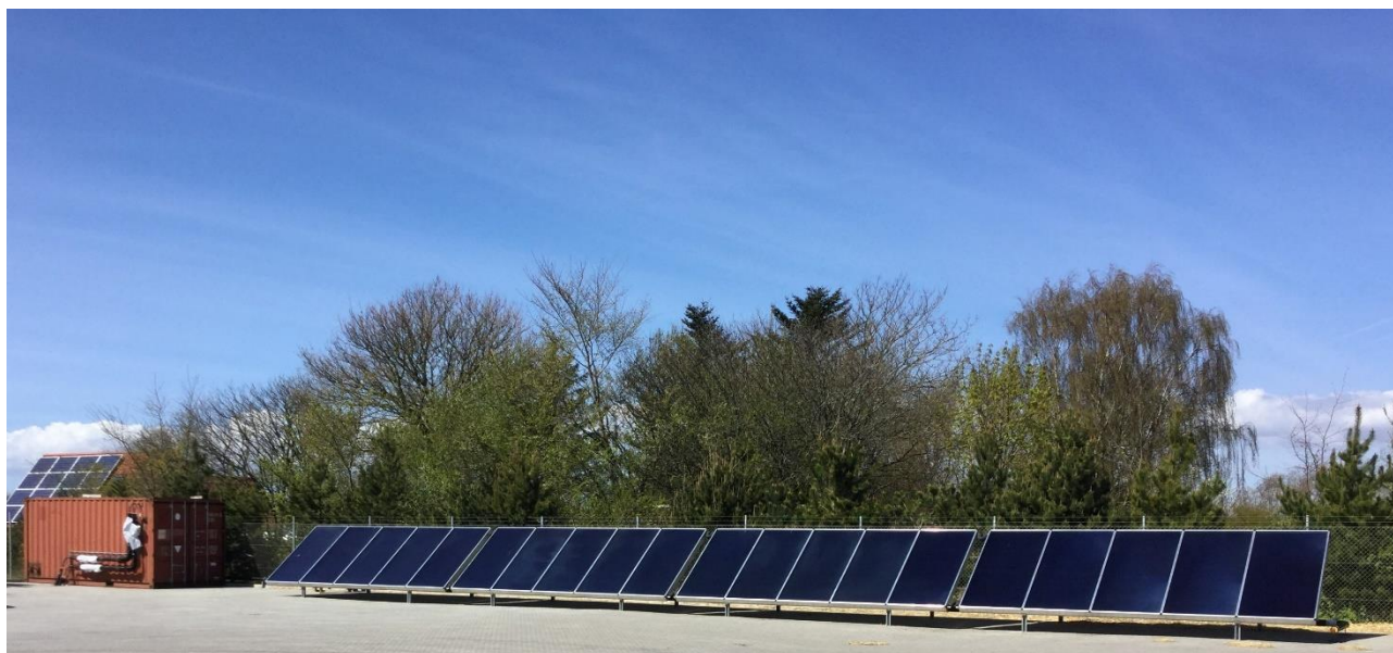
Figur 2.2: Testopstilling af GoT paneler ved Løgstør Fjernvarme
