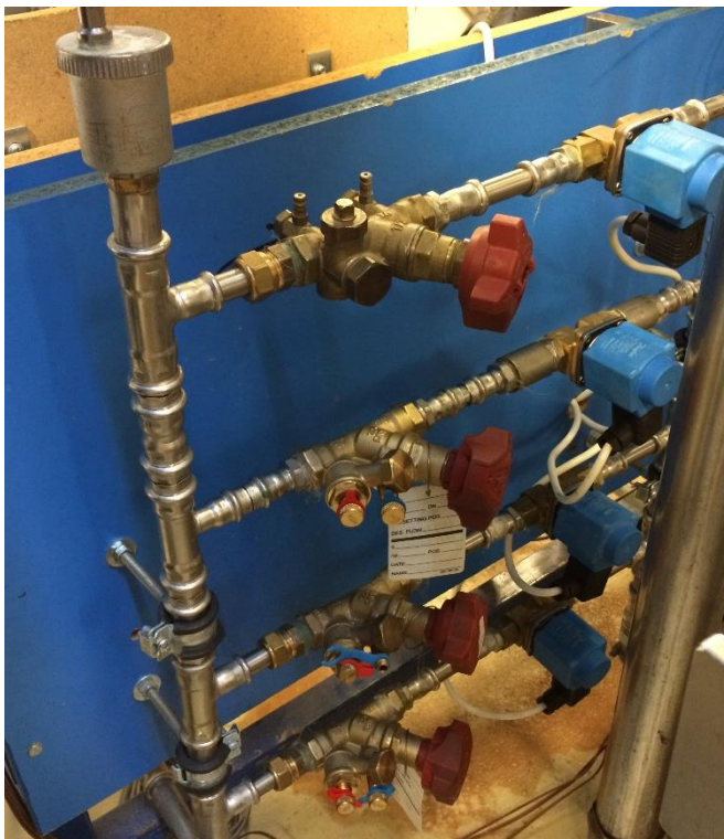
Figur 4-3 Brugsvand: Tappeautomat med fire magnetventiler, der kan åbnes/lukkes uafhængigt af hinanden. Det er også muligt at indregulere fire individuelle flow. Tappeautomaten sidder på brugsvandssiden og har monteret en flowmåler.
