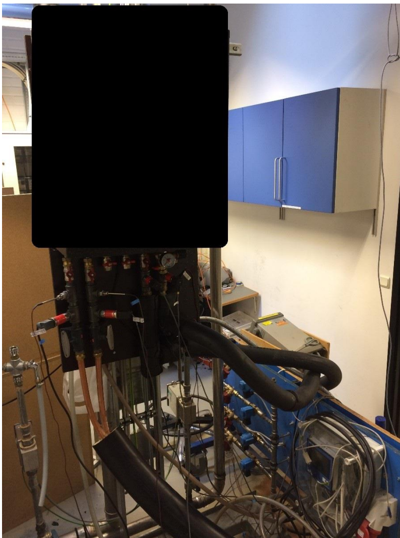
Figur 4-2 Ved vandvarmeren: Der er placeret tryk- og temperaturfølere på primærsiden (fjernvarmesiden) ved vandvarmeren, der er desuden placeret tryk og temperaturfølere på sekundærsiden (brugsvandssiden)
