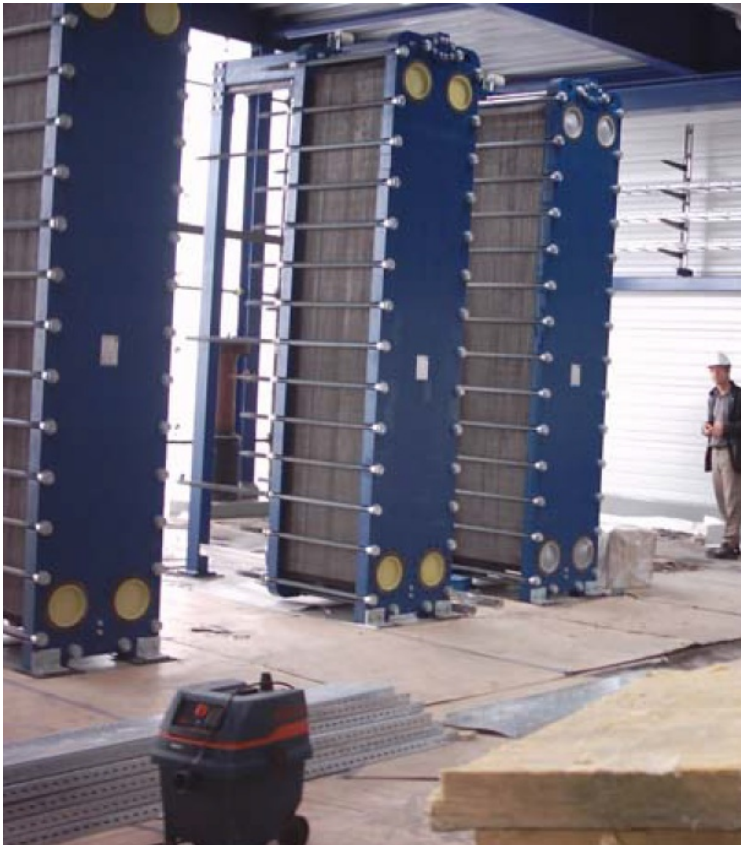
Figur 22: Høje, slanke pladevarmevekslere i serie sikrer en effektiv overførsel af energi fra geotermi- til fjernvarmevandet.
