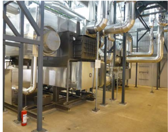
Figur 34: Absorptionsvarmepumpe efter installation (Sønderborg)
