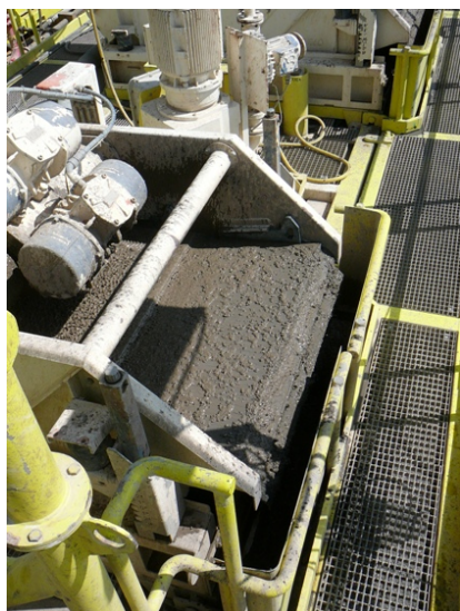
Figur 16: Behandling af boremudder.
