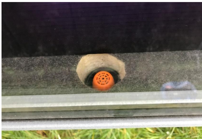
Figur 7. Datalogger monteret i hulrummet mellem absorber og glas.
