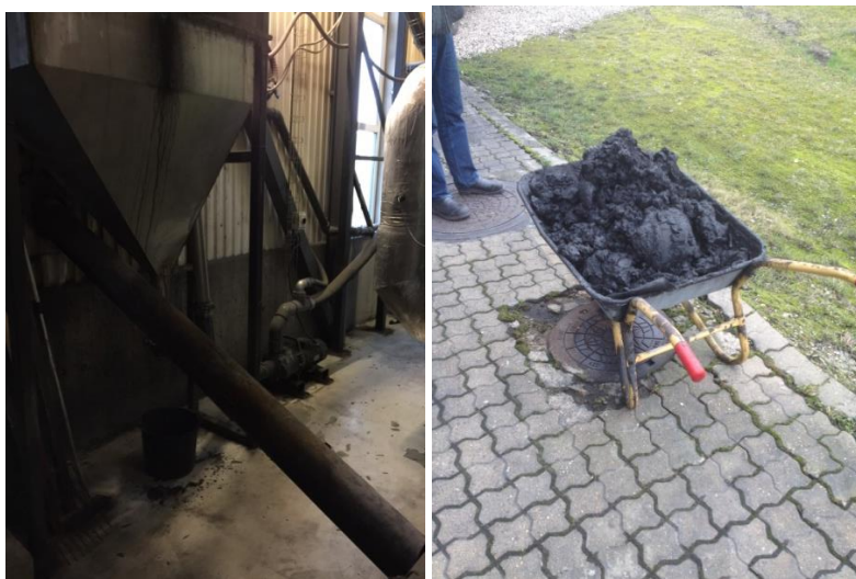
Billerer fra Gjøl. Tv. ses bundkar på scrubberen og en spand nedenunder hvor slam opsamles. Th. ses en trillebør med slam fra ca. en uge.
