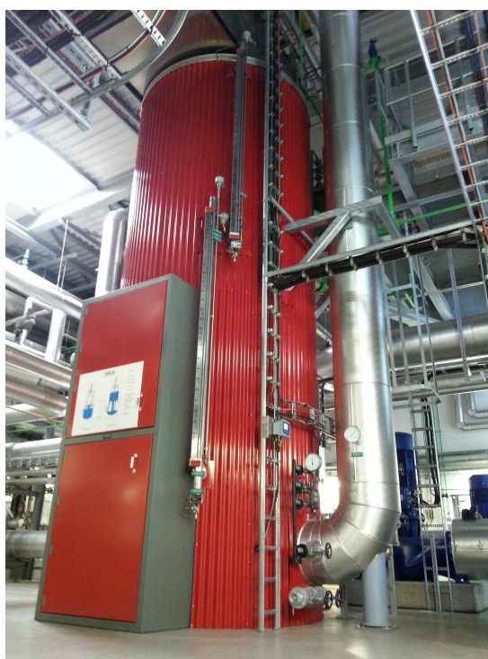
Figur 3: 40 MW anlæg hos Opel i Rüsselsheim af samme type som den der skal installeres hos CTR i 2018.
