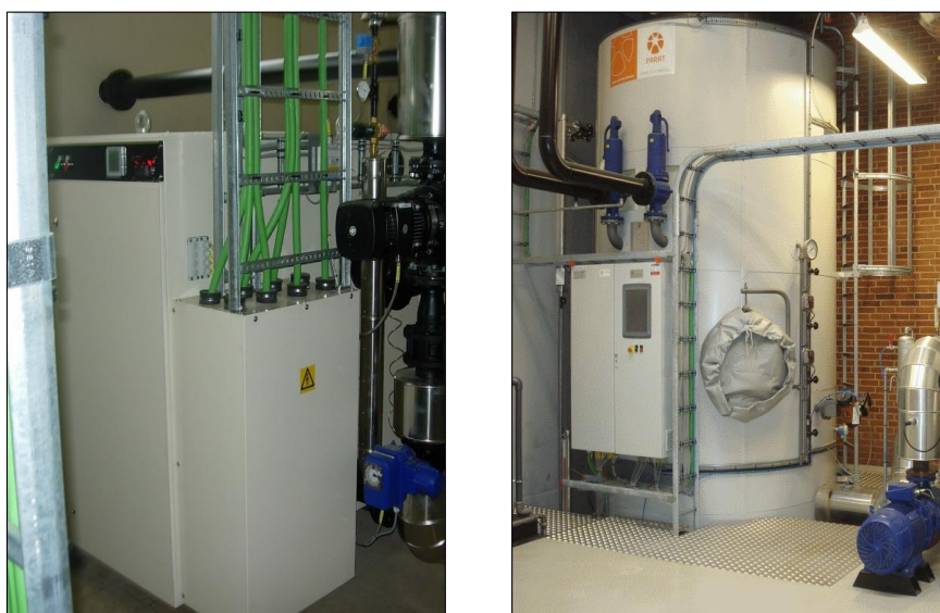
Figur 2: T.v. ses en elpatron (0,4 kV) og t.h. ses en elektrodekedel (10 kV)
